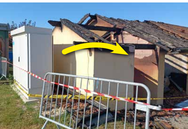
Déplacement de l'armoire.
